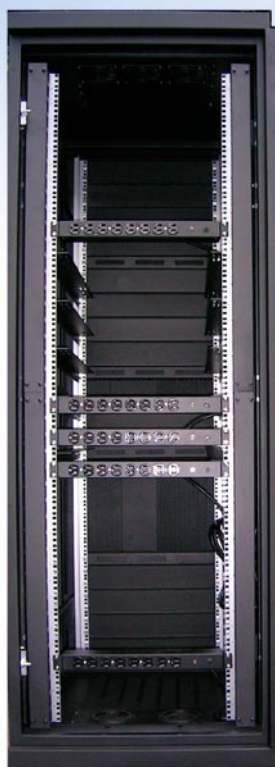
機櫃內部(背面)
